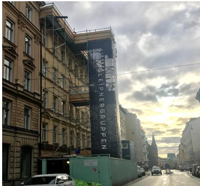
Exempel på bygghiss placerad på gatan framför fasaden.
